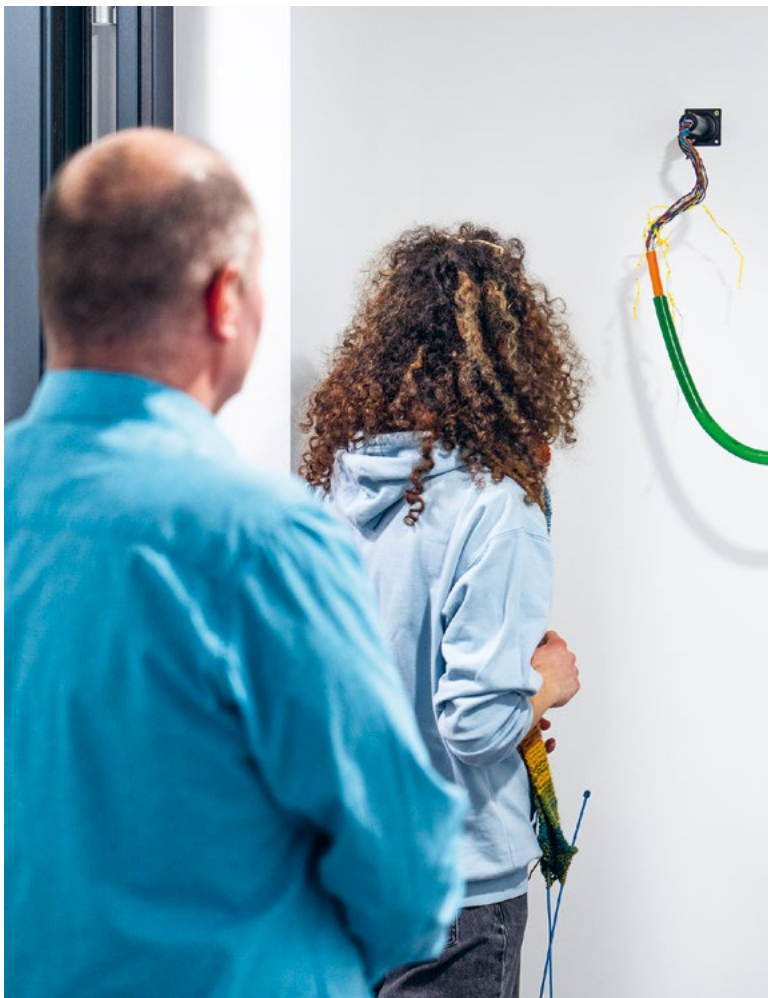
Rohre und Kabel, Installationsansicht Klaus Faber AG, 3.OG Nord
